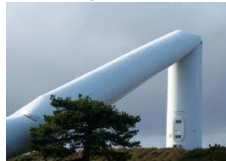
Flambage d'une éolienne
